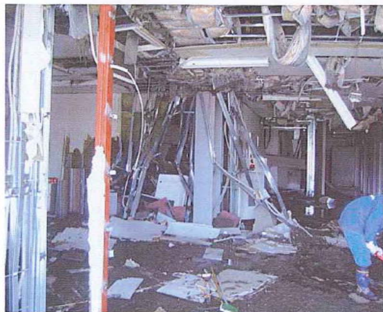
【(火力発電所)全冠水し損壊した事務所本館 1F】
