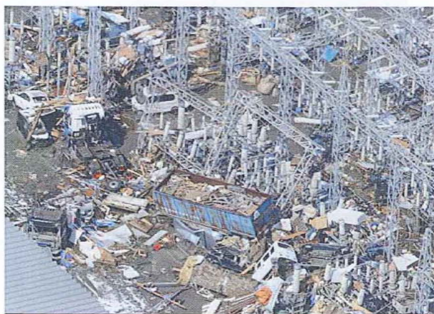
【(宮城県仙台市) 変電所大規模損壊】
