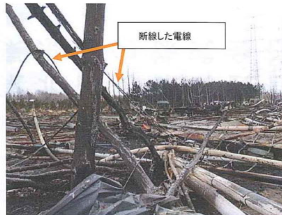
【(宮城県多賀城市)15万V送電線 電線断線】
