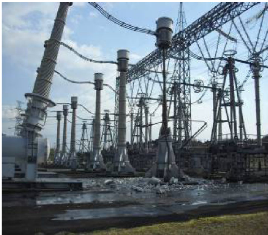
【500kV変電所】500kV計器用変流器損傷
