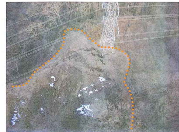
【(宮城県村田町) 27万V送電線 鉄塔敷地法面地滑り】
