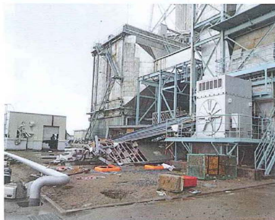
【(火力発電所)瓦礫類が流入したボイラ設備】
