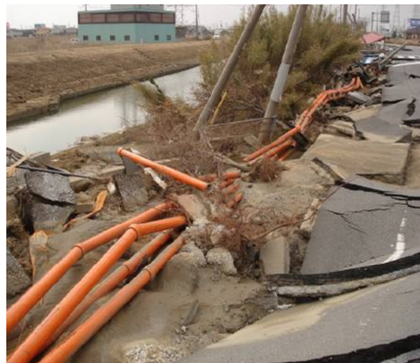
【66kV地中送電線】 路盤崩壊による管路損傷 【東京電力提供】
