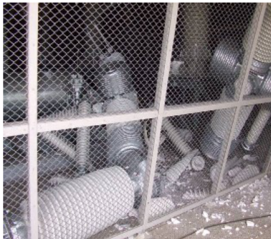
【275kV変電所】275kV遮断器損傷
