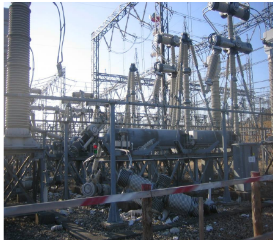
【500kV変電所】275kV遮断器損傷
