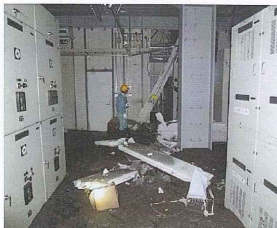
【(火力発電所)土砂が流入した電源盤室】
