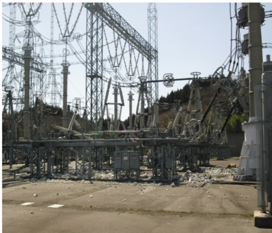
【500kV変電所】500kV断路器損傷
