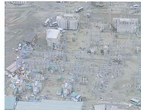
【(宮城県仙台市)構内浸水/変電所損壊】
