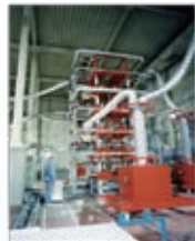
500kV-10MW負イオン中性粒子入射加熱装置用電源
