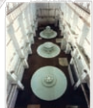
3台の電動発電機 BGJ、最大110万kW
