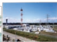
中央変電所 275kV
