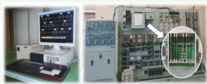
鉄道用単線自動閉そく 「電子閉そくシステム」 The Electronic Blocking System for Automatic Single- line Blocking System
