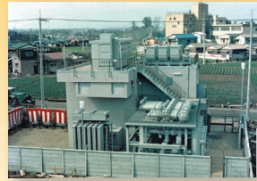
がすぜつえんかいせいち Gas Insulated Switchgear
