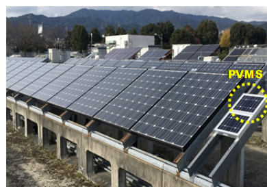
図 2 屋外高精度連続監視システムの外観
