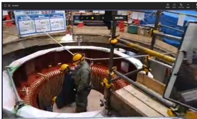
層雲峡発電所のオンライン設備見学
