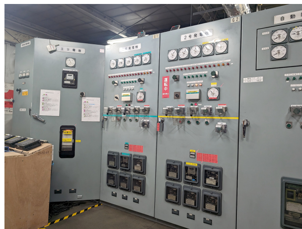
図 1 昭和基地にある発電機制御盤
