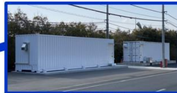
大容量蓄電池
