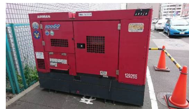
発電機(レンタル)
